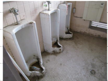
水洗機能を失った小便器
