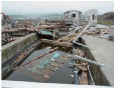
被災した汚水処理施設
