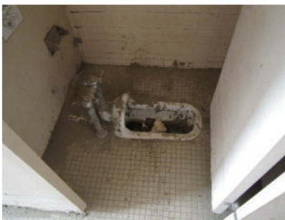
水洗機能を失った和式便器
