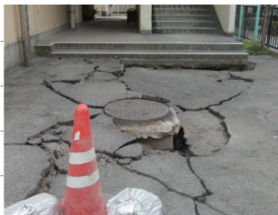
液状化で損壊したマンホール
